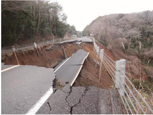
図1 被災したのと里山海道(横田IC~徳田大津JCT) 引用:石川県ホームページ
