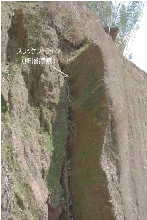
図15 崖に現れた断層面. 表面についた条線はスリッケン・ライン(断層擦痕)で, 断層の動いた方向を示す.
