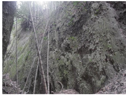
図 19 <用木> 浸食されやすく急崖を成す 荒々しい印象の露頭 関町城の坂
