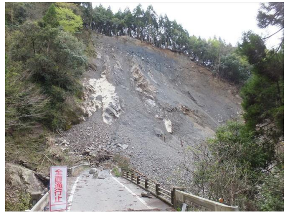
図5 甲馬隧道西尾谷川抗口の崩壊状況
