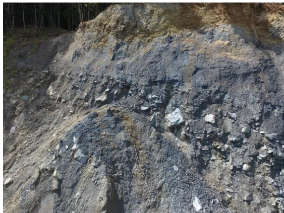
図7 崩壊現場の低角度破碎帯の近接写真
