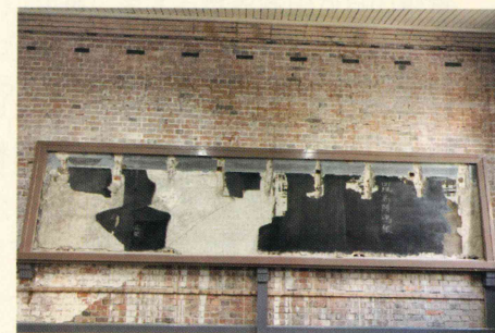
▲復旧工事中に発見された昔の黒板の痕跡
